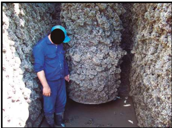
Macrofouling en el interior de un canal de riego. Paredes del túnel cubiertas por el mejillón dorado. Foto: Gustavo Darrigran.
